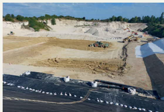
Mise en place de la couche d'argile (BSP) et de la géomembrane (BSA)
